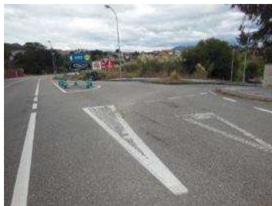
Foto 8. PK 11+960, sentido creciente, vista de cruce. Señalización horizontal en mal estado.
