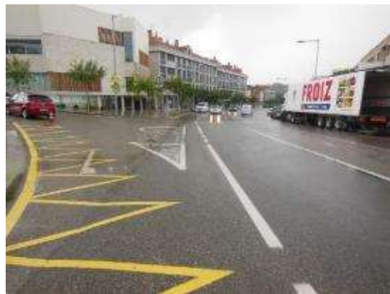
Foto 18. PK 12+610, marcas viales en mal estado.
