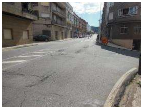
Foto 12. PK 10+840, sentido creciente, pavimento agrietado y pequeños blandones.
