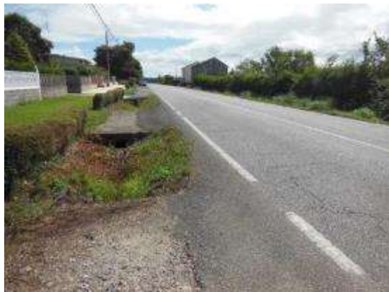
Foto 15. PK 3+680. Accesos a viviendas margen izquierdo. No existe señalización.
