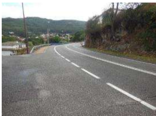
Foto 5. PK 4+620, incorporación margen derecho sin señalización horizontal. No existe continuidad en la senda.
