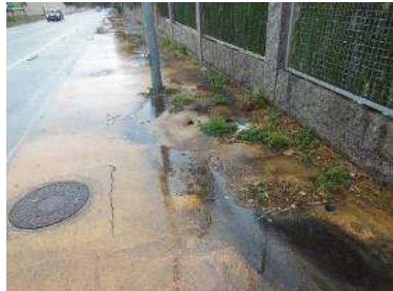
Foto 22. PK 12+830, detalle senda en mal estado, vegetación y acumulación de agua.
