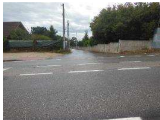
Foto 2. PK 1+390, incorporación margen izquierdo sin señalización.
