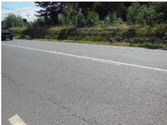
Foto 9. PK 3+220. Mal pintados o borrados los tacos. Es un lugar próximo a una glorieta.
