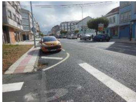
Foto 2. PK 2+050, sentido decreciente. Señalización horizontal de STOP en mal estado.
