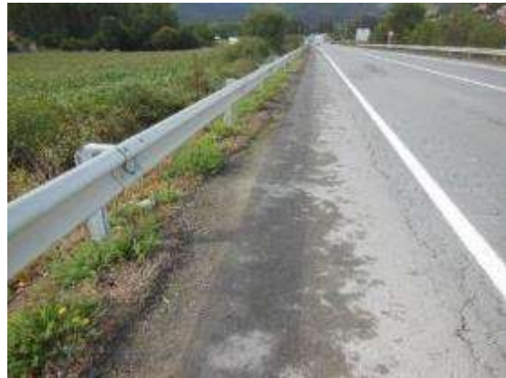
Foto 18. PK 1+070. Vegetación en margen izquierdo, puede provocar problemas de drenaje.
