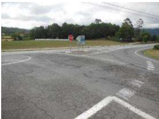
Foto 16. PK 0+900, intersección. Vista frontal, señalización vertical de STOP, marcas viales desgastadas y pavimento agrietado.
