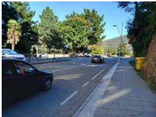
Foto 3. PK 84+560, sentido creciente. Elevación pavimento previa al paso de peatones.
