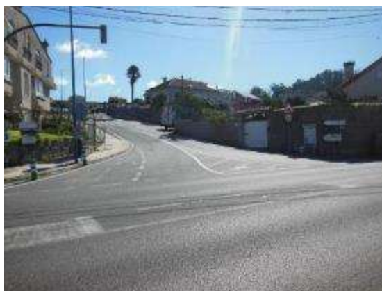
Foto 22. PK 2+890, intersección margen izquierdo, marcas viales en mal estado.
