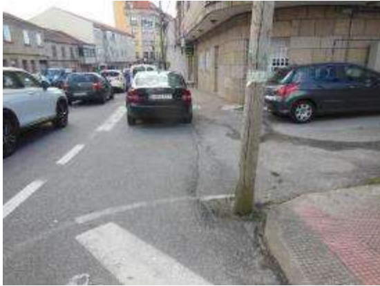
Foto 17. PK 9+140, sentido creciente. Incorporación margen derecho con vehículos mal estacionados. Sin señalización vertical y la horizontal desgastada.
