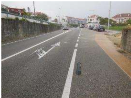
Foto 17. PK 12+560, sentido creciente.
