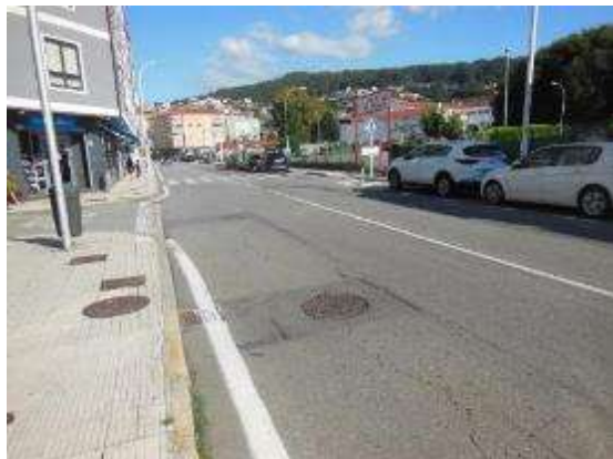
Foto 9. PK 0+640, sentido decreciente, incorporación margen derecho con señalización horizontal en mal estado.
