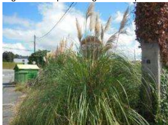
Foto 20. PK 3+900. Señal de STOP oculta por la vegetación, incorporación margen derecho.
