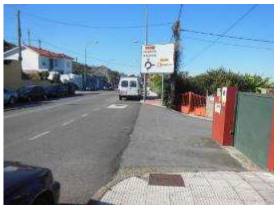
Foto 16. PK 2+220, sentido creciente. Incorporación margen derecho sin señalización. Marcas viales desgastadas.
