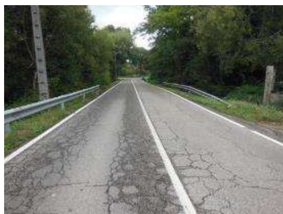
Foto 6. PK 0+680, sentido creciente. Vista general, pavimento agrietado.
