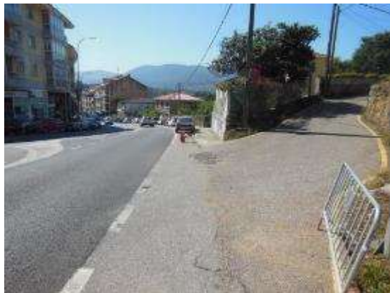
Foto 15. PK 12+540, incorporación margen derecho sin señalización. Marcas viales desgastadas.
