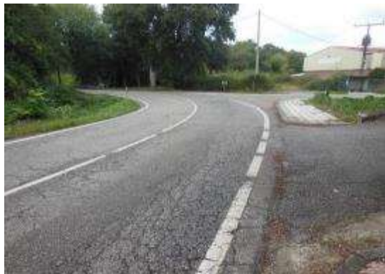
Foto 9. PK 0+810, sentido decreciente. Curva cerrada a la izquierda, visibilidad reducida, un único panel direccional. Firme agrietado.
