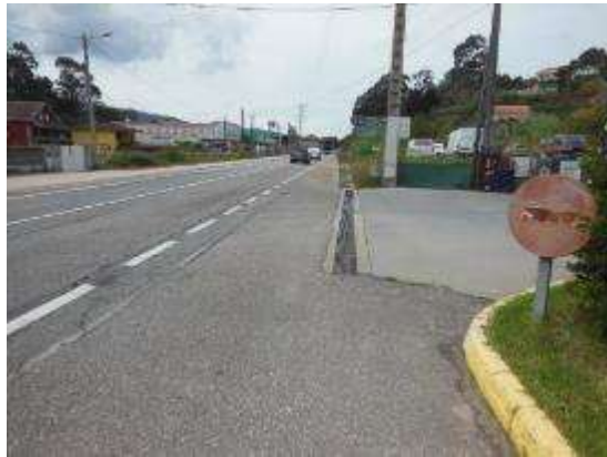
Foto 3. PK 17+950, sentido creciente. Incorporación margen derecho, salida de la gasolinera. Señal de prohibida la entrada muy antigua y desgastada situada a baja altura. Señal de STOP a baja altura y muy desgastada, no existe señalización horizontal.
