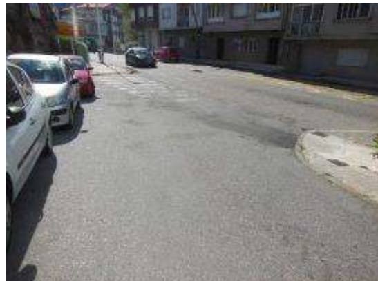
Foto 18. PK 11+090, incorporación margen izquierdo sin señalización. Paso de peatones en muy mal estado (inapreciable).
