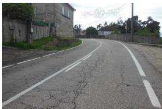
Foto 15. PK 0+940, sentido creciente. Firme agrietado, acceso a propiedades margen izquierdo sin señalización y con visibilidad reducida por edificación existente. Curva cerrada a la izquierda, se pierde la visibilidad del trazado, no existen paneles direccionales.
