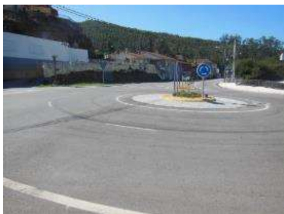
Foto 25. PK 3+060, sentido creciente, glorieta. Marcas de frenadas en la glorieta, incluso alguna atravesándola.
