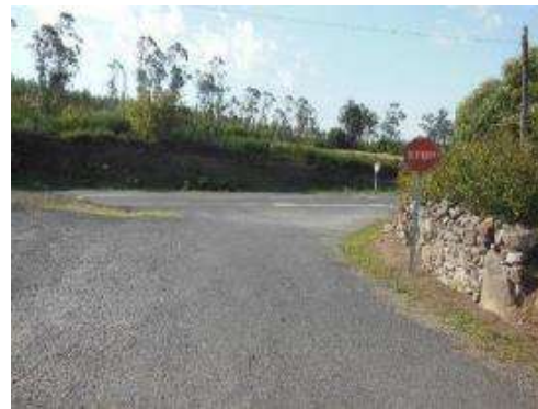
Foto 16. PK 75+300. Final de tramo. Señal deteriorada.
