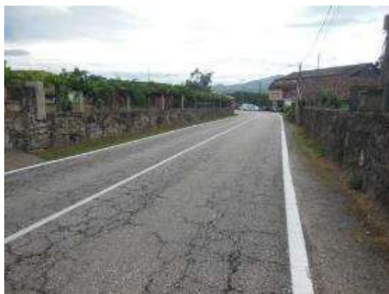
Foto 17. PK 1+030, sentido creciente, vista general. Firma agrietado y curva cerrada a la izquierda, se pierde la visibilidad del trazado.
