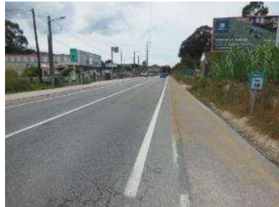
Foto 4. PK 18+000, sentido creciente. En margen derecho pintura de senda peatonal muy desgastada.
