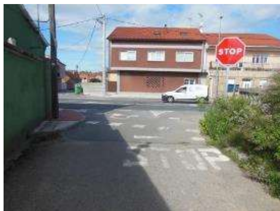
Foto 8. PK 8+660, incorporación margen izquierdo, señalización horizontal desgastada.
