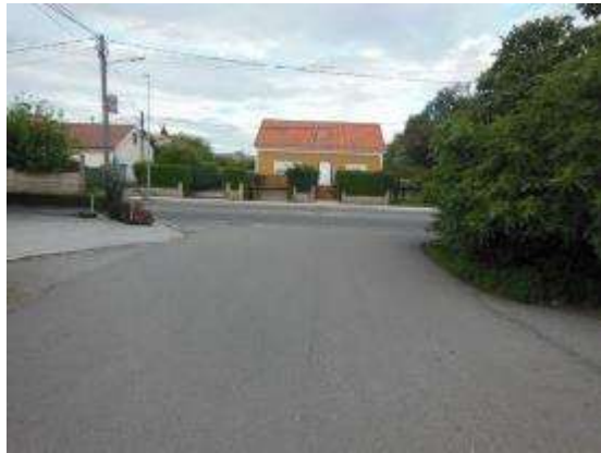
Foto 15. PK 4+770, incorporación margen izquierdo. Señal de STOP oculta entre la vegetación, sin señalización horizontal, se permite giro a la derecha y a la izquierda.
