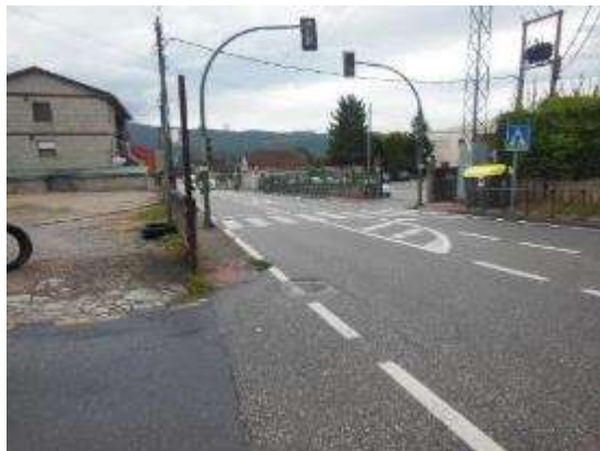
Foto 15. PK 1+820, incorporación margen derecho sin señalizar STOP. Vista hacia sentido decreciente, paso de peatones semaforizado junto a centro escolar.
