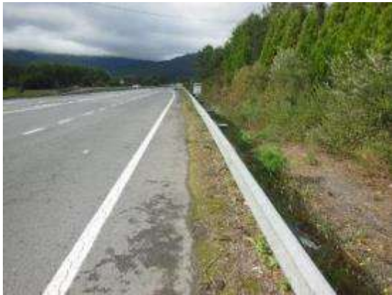
Foto 17. PK 1+000, sentido creciente. Vista general, márgenes con vegetación, pueden provocar problemas de drenaje.
