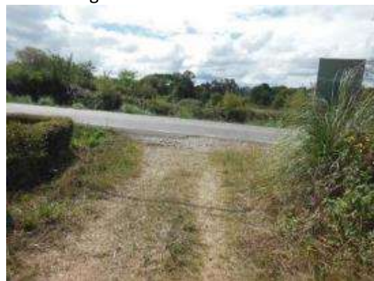
Foto 14. PK 3+670. Camino de acceso a propiedades, margen izquierdo. Sin señalización vertical ni horizontal, cambio de tipo de pavimento y diferencia de cota.
