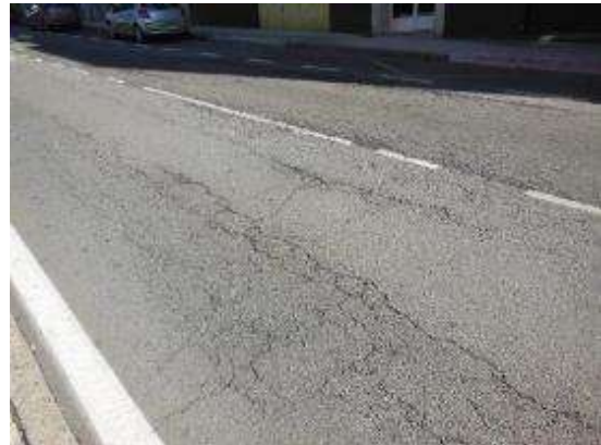
Foto 4. PK 0+060, detalle firme agrietado.
