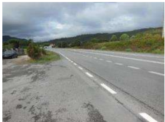
Foto 8. PK 0+700. Incorporación margen izquierdo sin señalización vertical ni horizontal de STOP.
