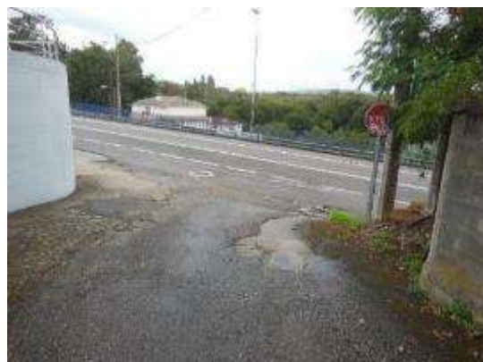
Foto 4. PK 4+530, incorporación margen izquierdo sin señalización horizontal. Cambio de rasante y firme discontinuo.
