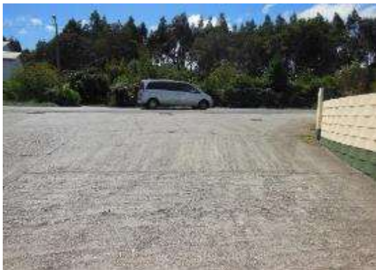
Foto 3. PK 2+870. Salida del centro. Falta señal de STOP.
