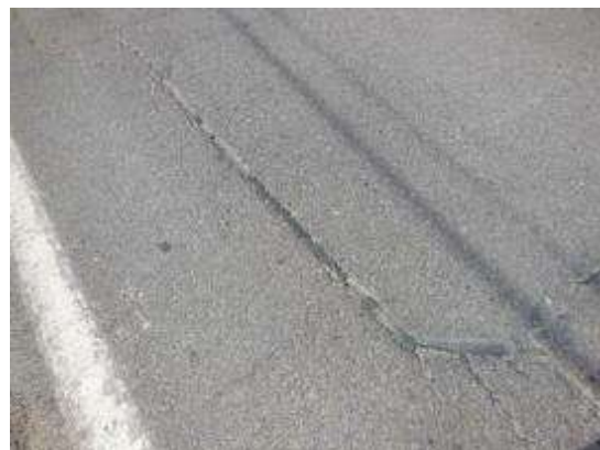
Foto 12. PK 3+550. Firme agrietado, espiras magnéticas de datos de tráfico.
