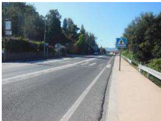
Foto 5. PK 10+920, sentido creciente. Paso de peatones y marcas viales desgastadas.
