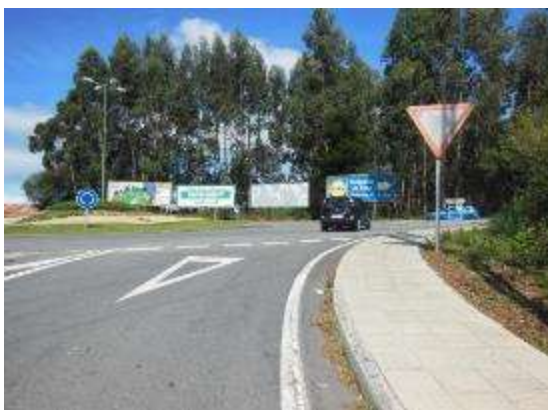
Foto 19. PK 3+680. Vista general de la glorieta. Señal de ceda antigua.
