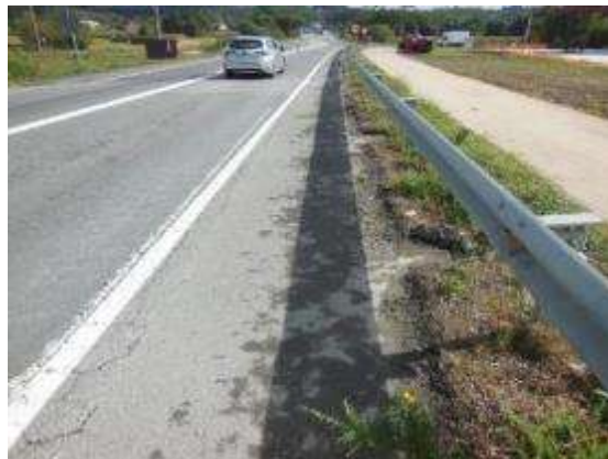
Foto 24. PK 1+450, sentido decreciente. Acumulación de tierra o restos de desbroce bajo la bionda que funcionan como un bordillo, impidiendo la salida de agua.
