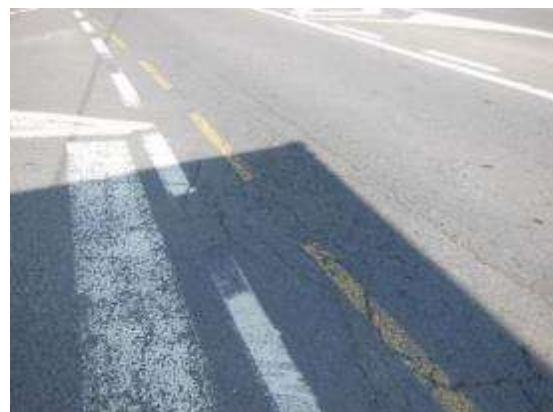
Foto 16. PK 23+420, sentido creciente, blandón.
