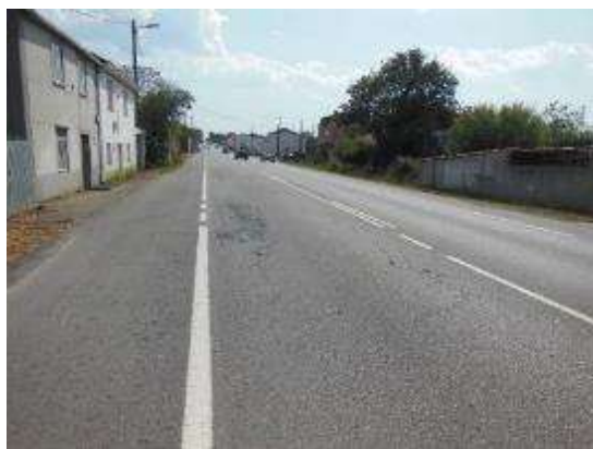
Foto 5. PK 28+800, sentido creciente. Blandón carril derecho, salidas de vivienda en margen izquierdo.
