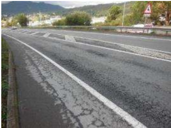
Foto 3. PK 0+100, sentido creciente. Pavimento agrietado "piel de cocodrilo".
