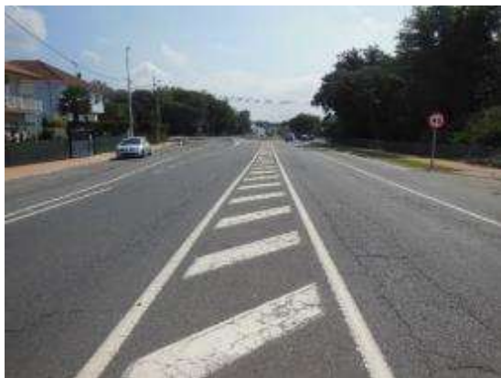
Foto 11. PK 23+330, sentido decreciente, vista general, blandones en margen izquierdo.
