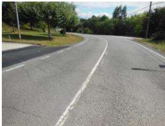
Foto 9. PK 3+460, sentido creciente. Marcas viales desgastadas, se permite el giro a la izquierda para acceder a la gasolinera, tacos muy desgastados.
