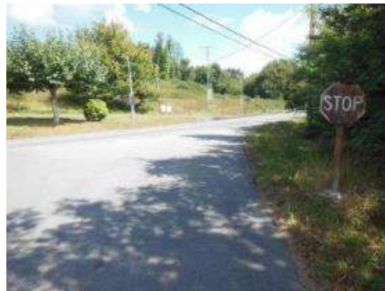
Foto 10. PK 3+500. Incorporación margen derecho con señal de STOP antigua y en mal estado. No existe señalización horizontal.
