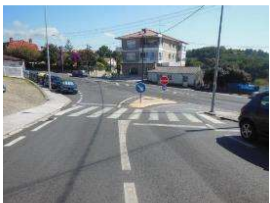
Foto 13. PK 12+120, incorporación margen derecho, señalización horizontal desgastada.
