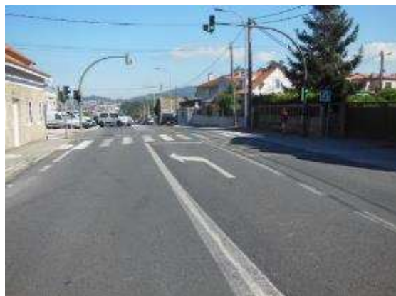
Foto 12. PK 12+010, sentido decreciente, intersección semaforizada. Paso de peatones y marcas viales desgastados.
