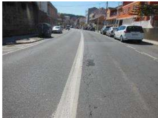
Foto 4. PK 10+160, sentido creciente. Vista general, pavimento agrietado.
