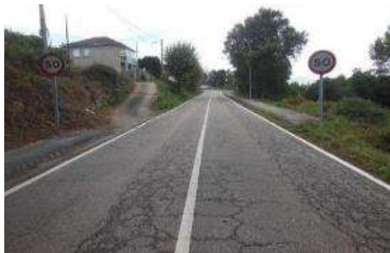
Foto 11. PK 0+830, sentido creciente, vista general. Prohibición de adelantamiento y velocidad limitada a 50 km/h. Firme agrietado. Acceso a viviendas margen izquierdo sin ninguna señalización.
