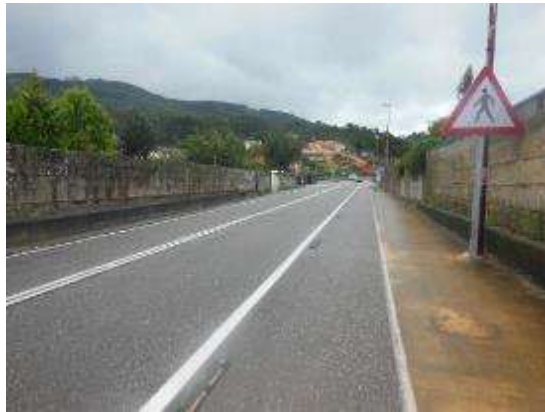
Foto 21. PK 3+370, sentido creciente. Señal de peligro por peatones.
