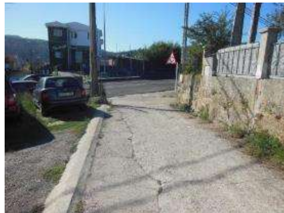
Foto 10. PK 1+530, incorporación margen derecho sin señalización. Cambio en el tipo de pavimento.
