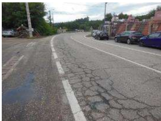
Foto 3. PK 0+590, vista hacia sentido creciente. Pavimento agrietado.
