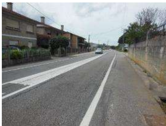
Foto 1. PK 17+900, sentido creciente, vista general inicio del tramo. Margen derecho senda peatonal con pintura inapreciable.
