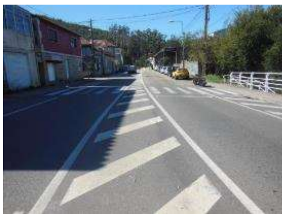
Foto 26. PK 3+100, sentido creciente. Vista general, paso de peatones desgastado.
