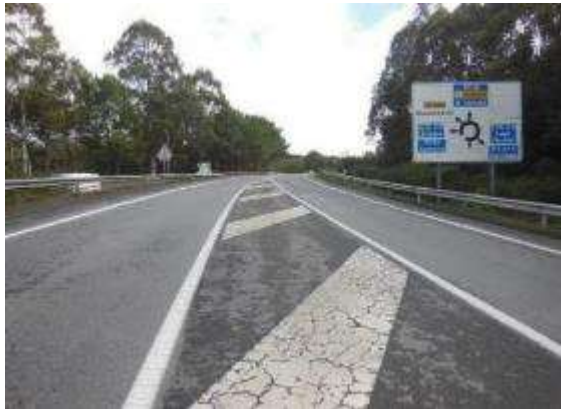
Foto 4. PK 0+150, sentido decreciente. Vista general. Cebreado de separación de carriles gastado.
