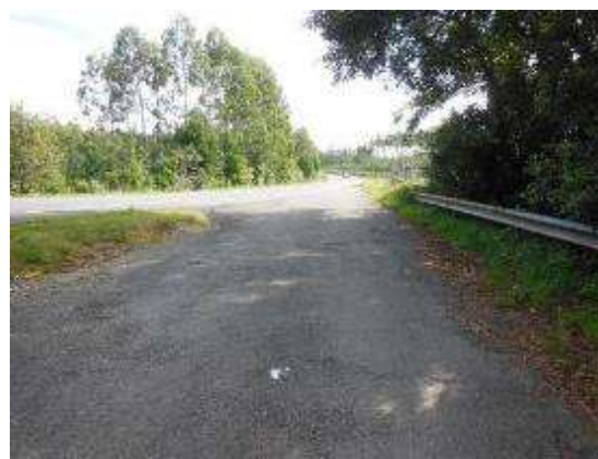
Foto 2. PK 74+400, incorporación sentido decreciente. Sin señal STOP.
