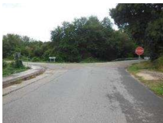
Foto 8. PK 0+780, intersección margen izquierdo. Señal de STOP. No existe señalización horizontal, discontinuidad en el pavimento.
