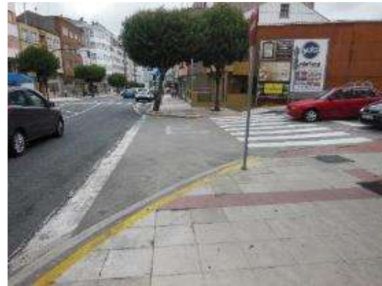
Foto 18. PK 2+910, incorporación margen derecho. Señalización horizontal desgastada y discontinuidad en el pavimento.
