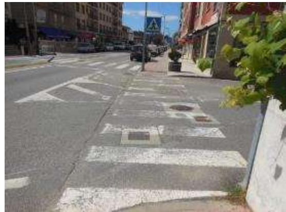
Foto 20. PK 9+320, incorporación margen derecho. Marcas viales en mal estado, paso de peatones en mal estado. Sin señalización vertical de STOP y la horizontal en mal estado. Discontinuidad en el pavimento.
