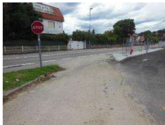
Foto 12. PK 12+350, incorporación margen izquierdo. Señal de STOP, cambio en el tipo de pavimento, sin señalización horizontal.
