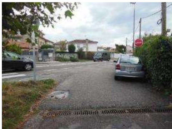
Foto 15. PK 5+190, incorporación margen derecho. Discontinuidad en el pavimento por sumideros instalados. Señal de STOP, sin señalización horizontal.
