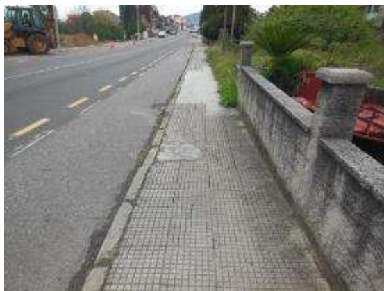
Foto 5. PK 4+130, vista hacia sentido decreciente, aceras en mal estado.
