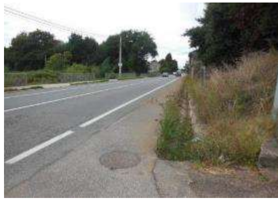
Foto 16. PK 18+380, margen derecho pintura de senda peatonal muy desgastada. Cunetas cubiertas de vegetación lo que supone problemas de drenaje.
