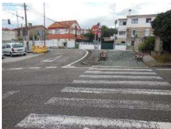
Foto 11. PK 5+080, señalización horizontal paso de peatones en mal estado.
