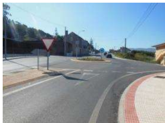
Foto 8. PK 11+130, sentido creciente, vista general glorieta, marcas viales desgastadas.
