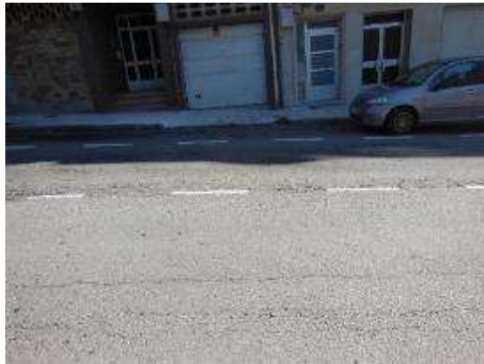
Foto 3. PK 0+060, detalle de firme agrietado.
