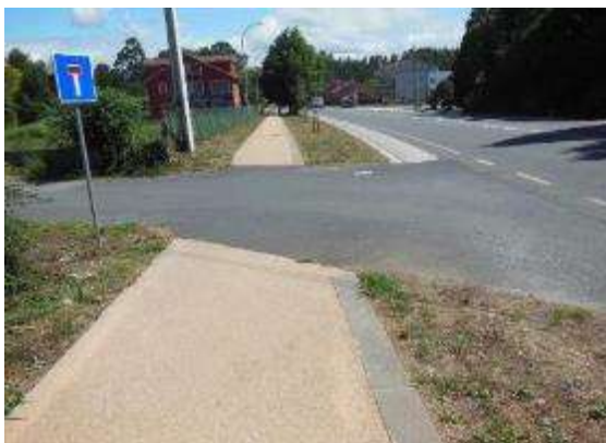
Foto 12. PK 3+390, sentido creciente. Falta paso de peatones para dar continuidad a la senda.
