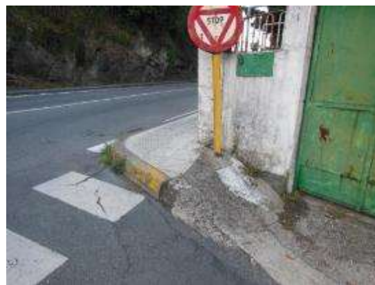
Foto 16. PK 1+160, incorporación margen derecho, señalización baja y antigua.
