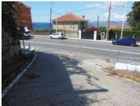
Foto 3. PK 10+150, incorporación margen izquierdo sin ninguna señalización, cambio de rasante y discontinuidad en el pavimento.
