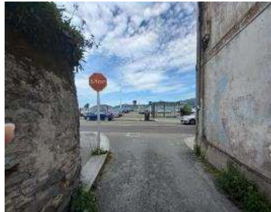
Foto 10. PK 83+600. Incorporación margen derecho muy estrecho. Mala visibilidad.
