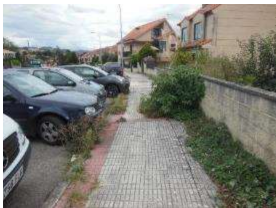
Foto 7. PK 11+870, aceras en mal estado y con vegetación.
