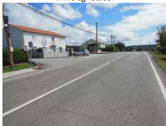
Foto 18. PK 3+840, sentido creciente. Vista general, cambio de rasante y firme agrietado. Se permiten giros a la izquierda.
