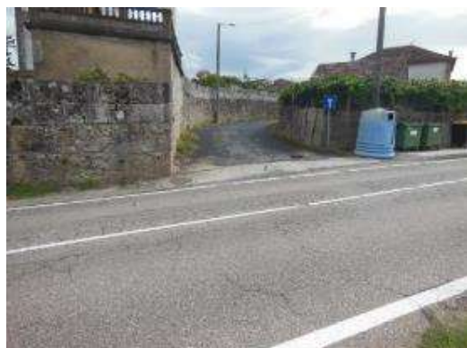
Foto 21. PK 1+460, acceso a viviendas margen izquierdo, sin señalización. Los contenedores reducen la visibilidad a la hora de incorporarse. Discontinuidad en el pavimento.
