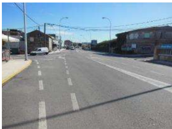
Foto 15. PK 2+110, vista hacia sentido decreciente. Intersección margen derecho, marcas viales desgastadas.
