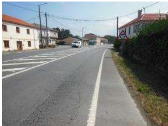
Foto 18. PK 23+450, sentido decreciente, blandón en margen izquierdo, arcén +/-1.0m
