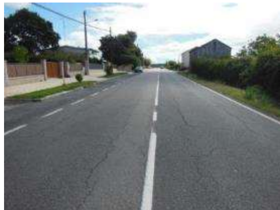
Foto 16. PK 3+700, sentido creciente. Vista general, tramo recto con buena visibilidad, firme agrietado.
