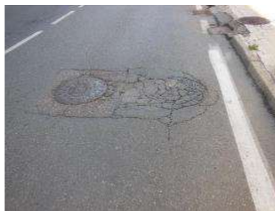
Foto 14. PK 0+760, sentido creciente blandón en el pavimento.
