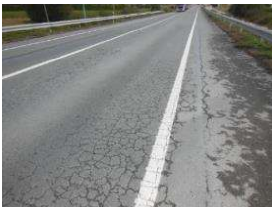
Foto 26. PK 1+590, sentido decreciente, pavimento agrietado "piel de cocodrilo".
