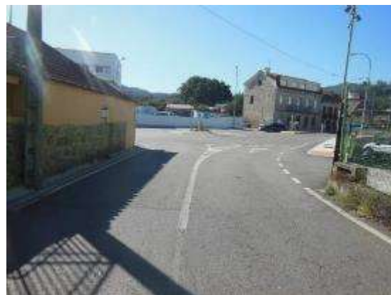
Foto 12. PK 1+780, ramal glorieta. Marcas viales desgastadas.
