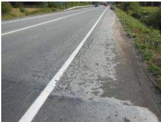
Foto 19. PK 1+260, sentido decreciente. Acumulación de tierra en el arcén, discontinuidad en el pavimento por diferencia de cota.
