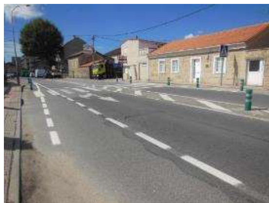
Foto 6. PK 8+500, vista hacia sentido creciente. Acumulación de arena y tierra en la zona del carril de deceleración. Discontinuidad en el pavimento entre ambos carriles.
