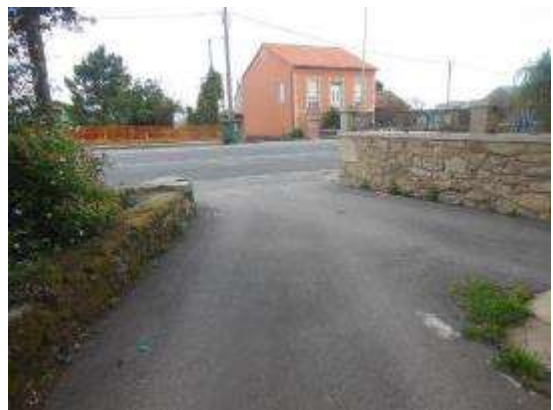
Foto 8. PK 4+340, incorporación margen izquierdo sin señalización.
