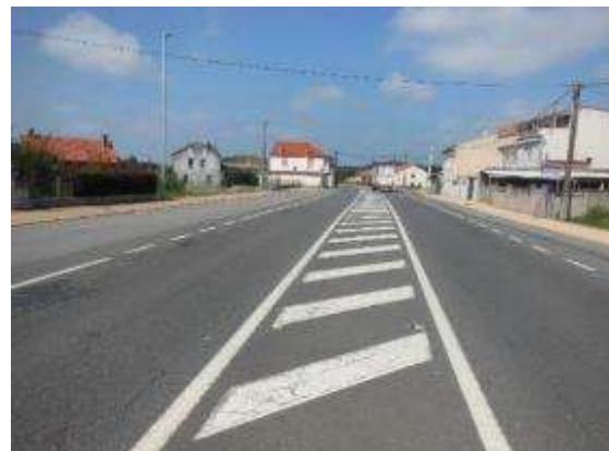
Foto 12. PK 23+330, sentido creciente, blandones en margen izquierdo.
