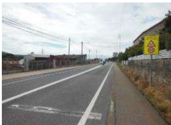
Foto 17. PK 18+580, sentido creciente. Señalización vertical de zona escolar, marcas viales horizontales transversales de advertencia muy desgastadas.
