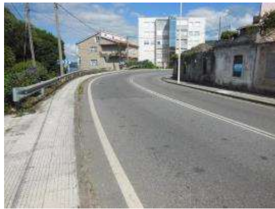
Foto 10. PK 10+630, sentido decreciente, curva cerrada a la derecha, se pierde la visibilidad del trazado. Paneles direccionales desgastados.
