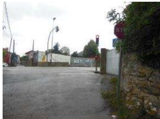
Foto 24. PK 3+450, intersección margen izquierdo regulada por semáforos. Señal de STOP oculta por la vegetación.
