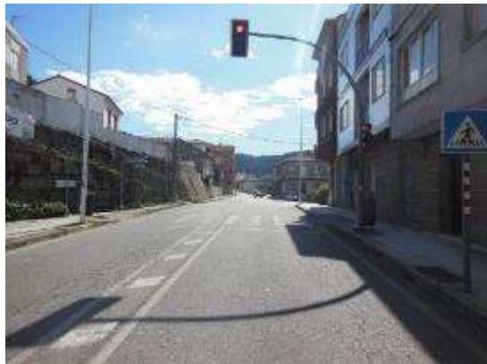
Foto 17. PK 11+100, sentido creciente, paso de peatones y marcas viales en mal estado.
