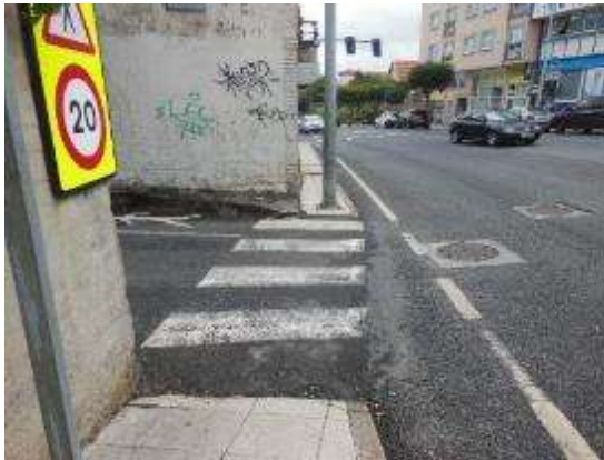
Foto 17. PK 2+260, acceso a viviendas margen izquierdo. Aceras muy estrechas y visibilidad reducida de los vehículos que circulan en sentido decreciente.
