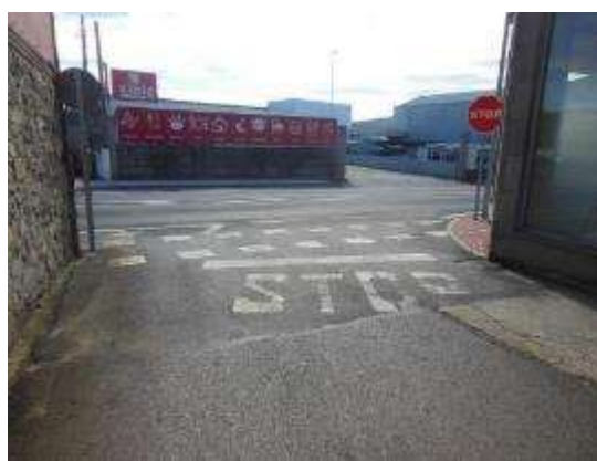
Foto 10. PK 8+890, incorporación margen derecho. Señalización horizontal desgastada. Visibilidad reducida y paso de peatones sin señalizar.
