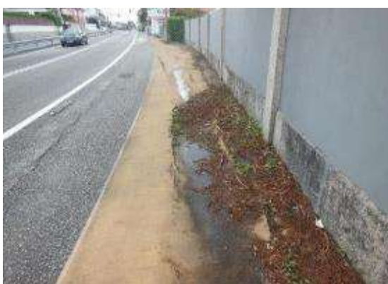
Foto 7. PK 4+950, sentido creciente, senda peatonal en mal estado y con vegetación.
