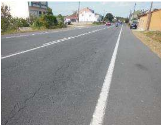
Foto 1 PK 28+610, sentido creciente, blandón carril derecho.
