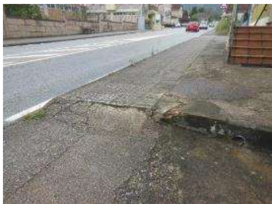
Foto 9. PK 1+560, margen derecho, acera en mal estado de conservación.
