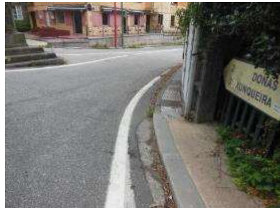
Foto 12. PK 18+200, intersección, detalle de acera casi inexistente en zona de curva y con poca visibilidad, los peatones invaden la calzada para continuar su itinerario.
