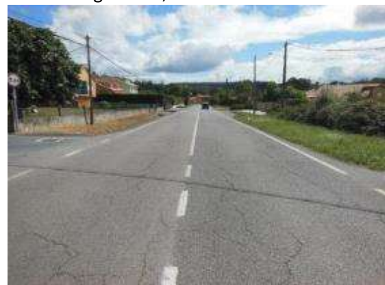
Foto 24. PK 3+900, sentido creciente. Vista general pavimento agrietado.
