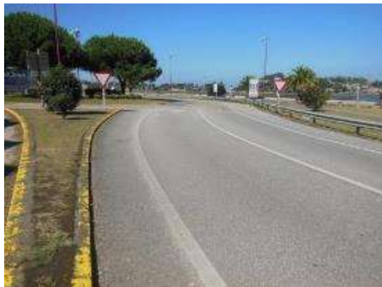
Foto 21. PK 13+010, sentido creciente, glorieta. Marcas viales, señalización horizontal de la isleta y señalización horizontal de ceda en mal estado.
