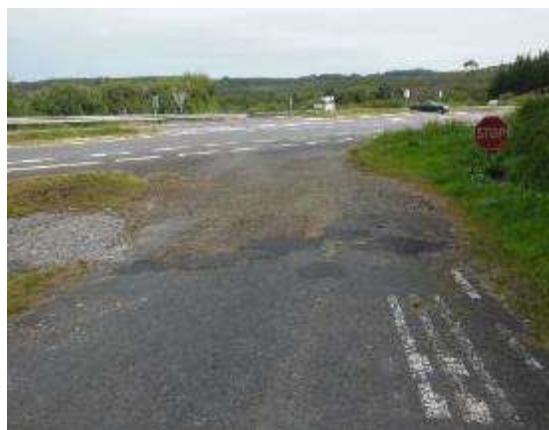
Foto 8. PK 74+820, incorporación en mal estado, señal STOP a baja altura.
