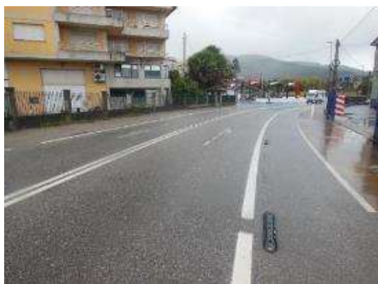
Foto 7. PK 2+380, sentido creciente vista general, símbolos viales desgastados.
