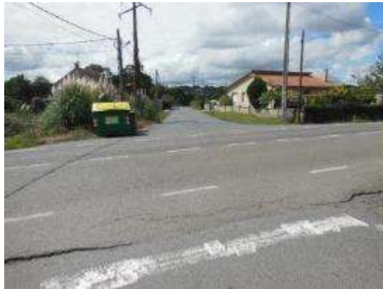
Foto 21. PK 3+900. Incorporación margen izquierdo. Señalización horizontal en mal estado.
