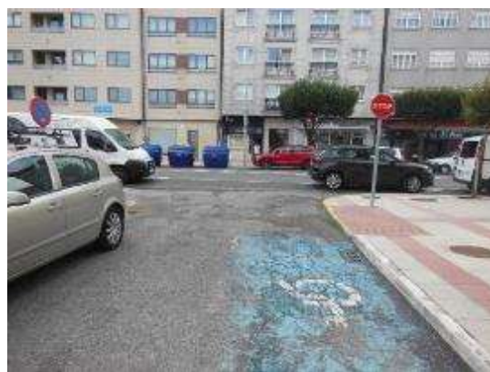
Foto 6. PK 2+470, margen izquierdo. Plaza PMR en mal estado de conservación. Señal de STOP.
