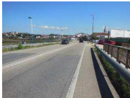
Foto 24. PK 13+200, sentido decreciente, vista general, marcas viales en mal estado.
