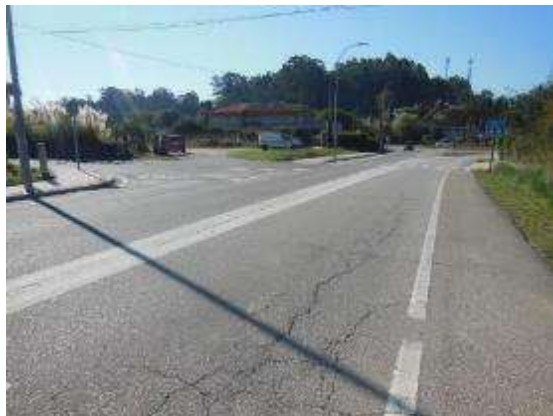
Foto 3. PK 10+720, sentido creciente. Incorporación margen izquierdo, pavimento agrietado, marcas viales desgastadas.
