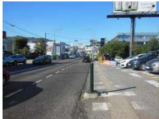
Foto 6. PK 1+190, sentido creciente, margen derecho discontinuidad en el pavimento. Paso de peatones muy deteriorado.
