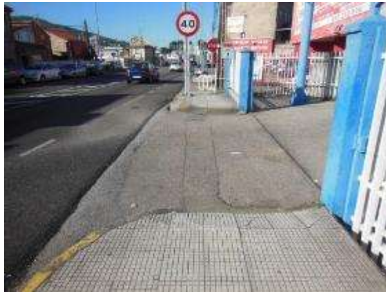
Foto 3. PK 1+010, acceso a superficies comerciales margen derecho sin señalización. Discontinuidad en el pavimento por diferencia de cota.
