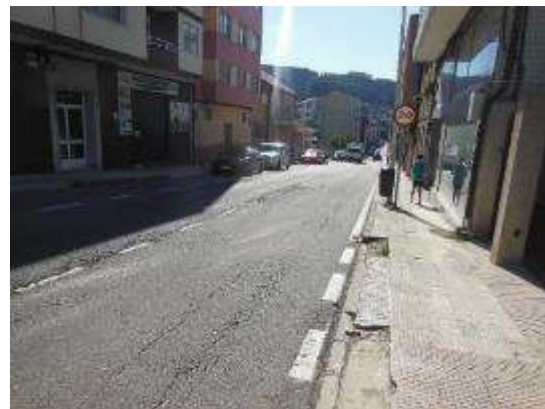
Foto 2. PK 0+060, sentido creciente, límite de velocidad 30 km/h. Firme agrietado.
