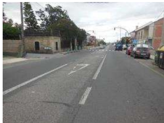
Foto 12. PK 4+570, sentido creciente, vista general. Carril central de espera para giro a la izquierda, marcas viales desgastadas.
