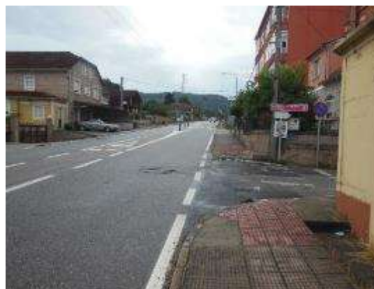
Foto 10. PK 1+620, sentido creciente. Incorporación margen derecho sin señalización. Paso de peatones en mal estado casi inapreciable.
