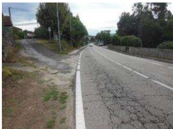
Foto 19. PK 1+160, vista hacia sentido creciente. Pavimento agrietado sentido decreciente. Acceso a viviendas margen izquierdo sin señalización, con cambio de rasante y visibilidad reducida.
