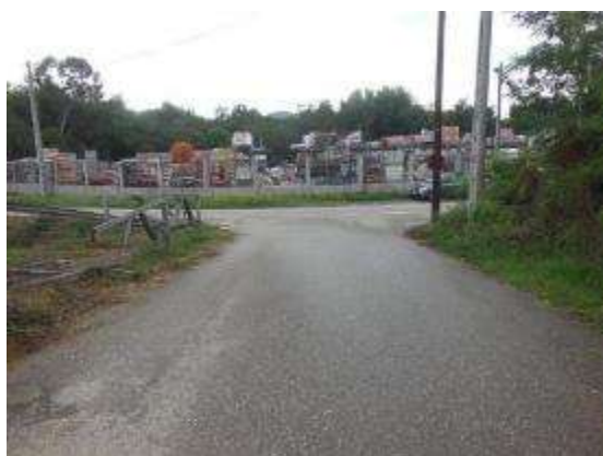
Foto 5. PK 0+640, intersección margen izquierdo, sin señalización. Discontinuidad en el pavimento.
