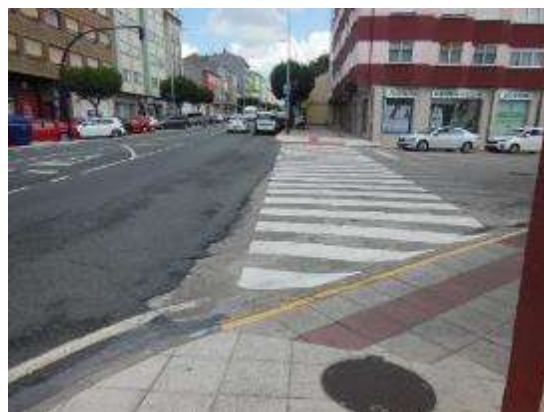
Foto 10. PK 3+740, sentido creciente. Incorporación margen derecho. Discontinuidad en el pavimento por diferencia de cota.
