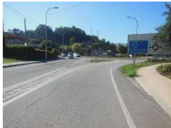
Foto 4. PK 10+750, sentido creciente. Vista general glorieta, marcas viales desgastadas.
