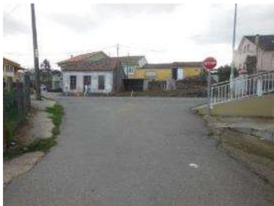
Foto 11. PK 4+460, incorporación margen derecho. Señal de STOP, no existe señalización horizontal, cambio de rasante.
