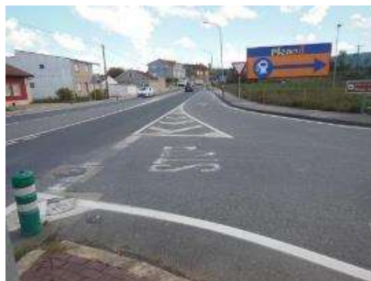
Foto 4. PK 8+460, intersección con cambio de sentido. Señalización horizontal en mal estado.
