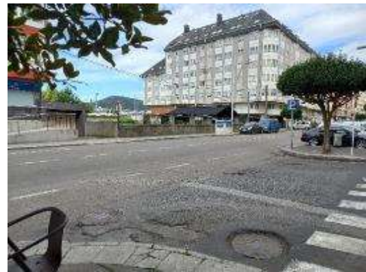
Foto 18. PK 84+320, incorporación margen derecho sin señalización horizontal y firme deteriorado.
