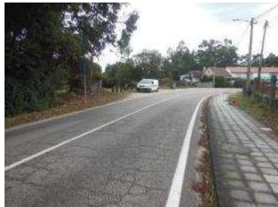
Foto 2. PK 0+540, sentido decreciente. Curva cerrada a la derecha, se pierde la visibilidad del trazado. Firme agrietado.
