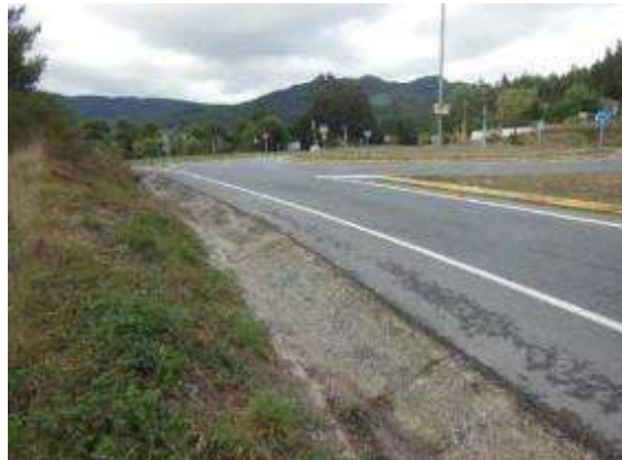
Foto 30. PK 1+780, sentido decreciente, cuneta descubierta.
