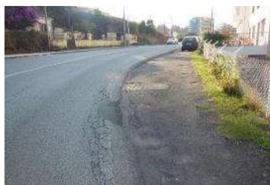
Foto 20. PK 1+440, sentido creciente, marcas viales en mal estado. Margen derecho con discontinuidad en el pavimento, diferente cota.
