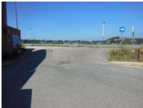
Foto 23. PK 13+200, incorporación margen izquierdo desde aparcamiento sin señalización de STOP.
