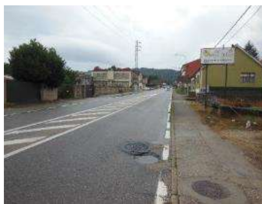
Foto 8. PK 1+540, sentido creciente. Bache en el pavimento y acera en mal estado.
