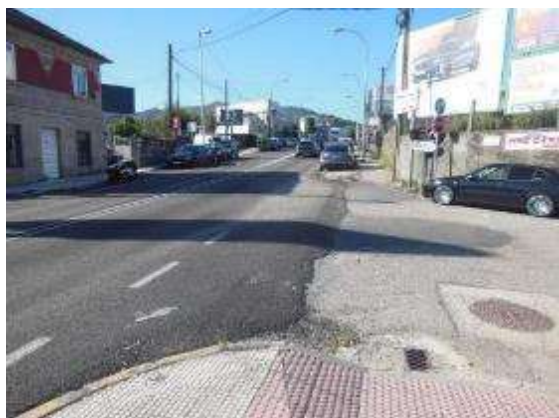
Foto 7. PK 1+380, sentido creciente. Incorporación margen derecho sin señalización horizontal, diferencia de cota por discontinuidad entre pavimentos.
