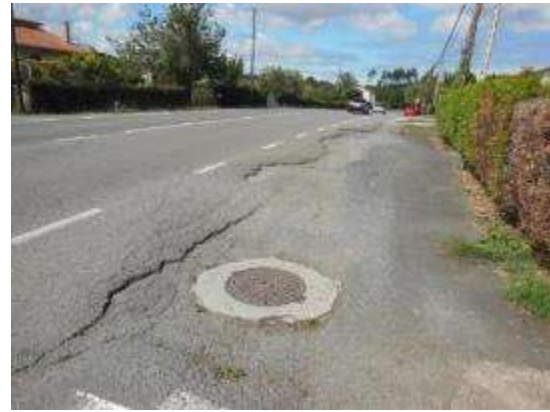
Foto 22. PK 3+900. Incorporación margen izquierdo sentido decreciente. Firme agrietado, cambio de cota.
