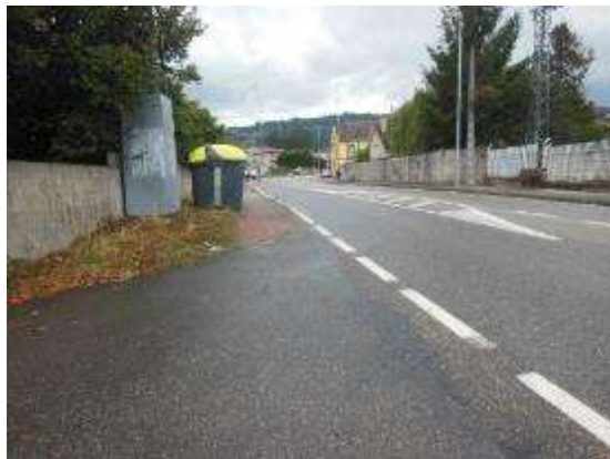
Foto 3. PK 1+390, incorporación margen izquierdo sin señalización ni dirección obligatoria a la derecha.
