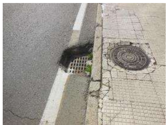
Foto 8. PK 0+580, socavón margen derecho por sumidero.
