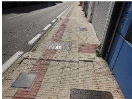
Foto 6. PK 0+130, aceras en mal estado.
