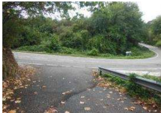
Foto 10. PK 0+810, incorporación acceso a viviendas, margen izquierdo. No existe señalización. Discontinuidad en el pavimento, cambio de rasante y visibilidad reducida de vehículos que circulan en sentido decreciente.
