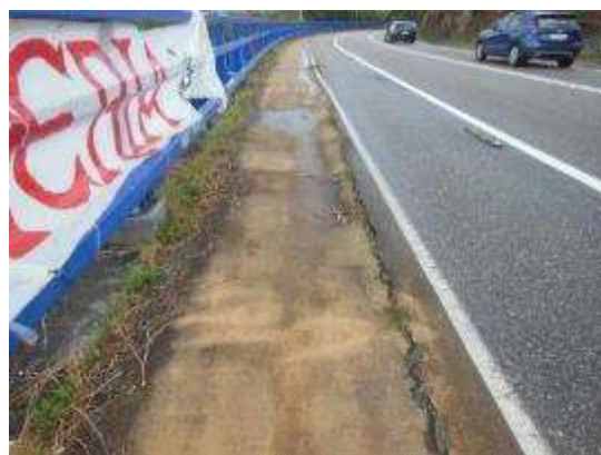
Foto 6. PK 4+550, detalle senda peatonal en mal estado.
