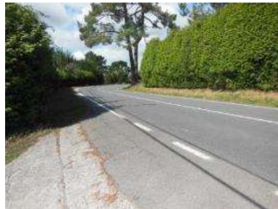
Foto 2. PK 2+850, sentido decreciente. Curva pronunciada a la derecha, visibilidad reducida.
