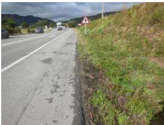
Foto 7. PK 0+700, sentido creciente.
