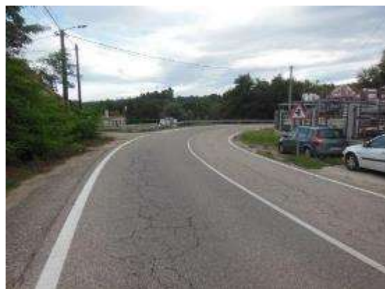
Foto 4. PK 0+620, sentido creciente. Curva cerrada a la derecha, se pierde visibilidad del trazado. Existe un único panel direccional. Señal de intersección con prioridad.
