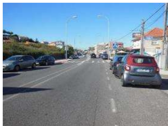
Foto 14. PK 2+000, sentido creciente. Vista general, marcas viales desgastadas.
