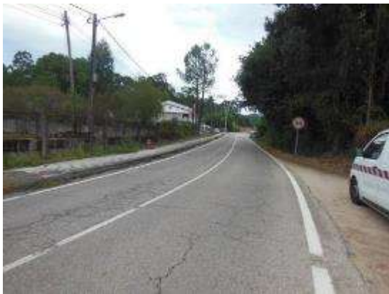
Foto 1. PK 0+500, sentido creciente, vista general inicio del tramo. Margen derecho discontinuidad entre carril y arcén (arcén de tierra).
