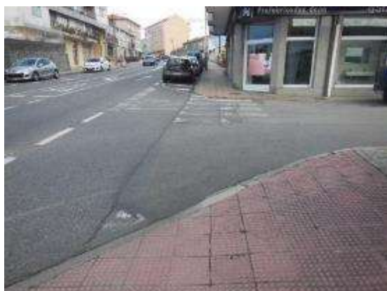
Foto 15. PK 9+020, vista hacia sentido decreciente. Incorporación sin señal de STOP y con señalización horizontal casi inapreciable. Paso de peatones inapreciable.
