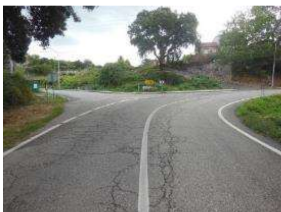
Foto 7. PK 0+760, sentido creciente. Curva cerrada a la derecha, un único panel direccional, se pierde la visibilidad del trazado.
