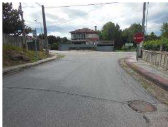
Foto 20. PK 1+390, incorporación margen izquierdo. Señal de STOP. No existe señalización vertical ni paso de peatones que dé continuidad a las aceras.
