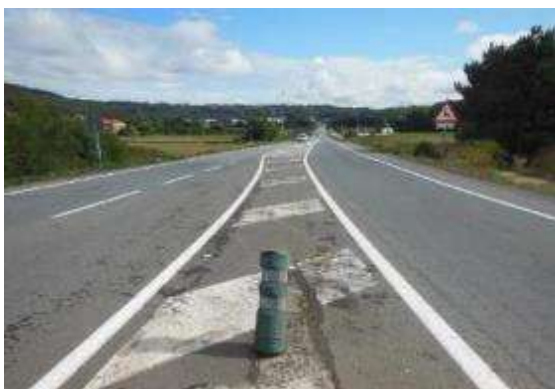
Foto 27. PK 1+760, sentido decreciente. Balizamiento en mal estado antes de la glorieta.
