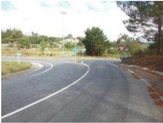
Foto 29. PK 1+810, ramal glorieta DP-3109 Peiro. Restos de vegetación margen derecho y marcas de frenadas de vehículos.
