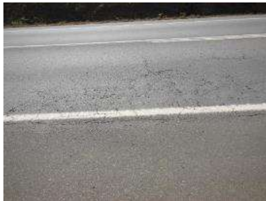
Foto 24. PK 23+920, sentido creciente, blandón.
