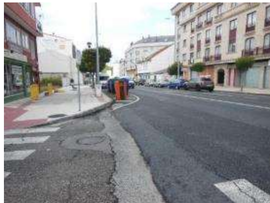
Foto 4. PK 2+200, incorporación margen derecho, discontinuidad en el pavimento por diferencias de cota.
