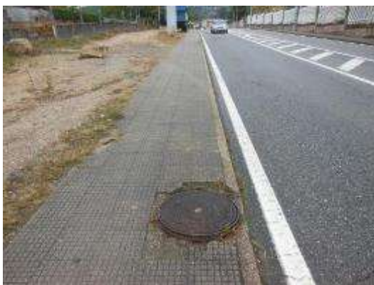
Foto 1. PK 1+340, vista en sentido creciente, aceras en mal estado.
