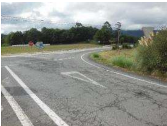
Foto 15. PK 0+900, intersección. Vista frontal, señalización horizontal en mal estado, pavimento agrietado "piel de cocodrilo".
