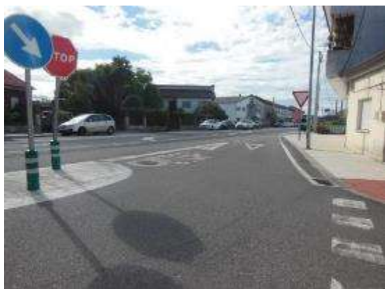
Foto 7. PK 8+660, cambio de sentido, vista hacia sentido decreciente, señalización horizontal desgastada.
