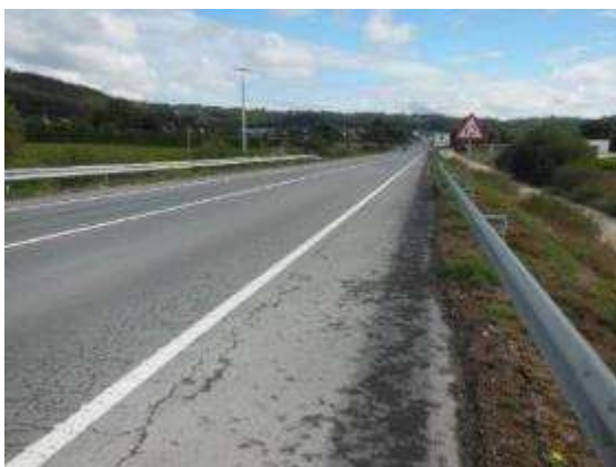
Foto 25. PK 1+550, sentido creciente. Acumulación de tierra y vegetación bajo la bionda, problemas de drenaje.
