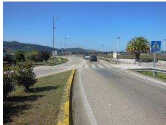
Foto 22. PK 13+090, sentido creciente. Marcas viales, señalización horizontal de la isleta y paso de peatones en mal estado.
