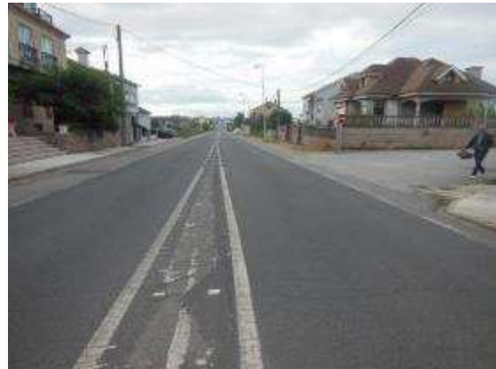
Foto 16. PK 4+810, sentido creciente, vista general. Marcas viales desgastadas.
