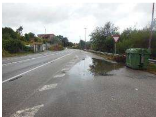
Foto 27. PK 3+830, sentido creciente. Carril de incorporación, marcas viales desgastadas. Contenedor ocupando parte del carril de incorporación.
