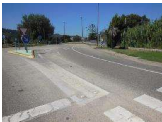
Foto 25. PK 13+730, sentido creciente, glorieta. Marcas viales, paso de peatones, señalización horizontal de ceda e isletas en mal estado.
