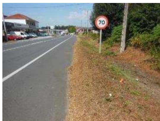
Foto 7. PK 28+900, sentido creciente. Arcén con restos de desbroce, impide salida de agua a la cuneta.
