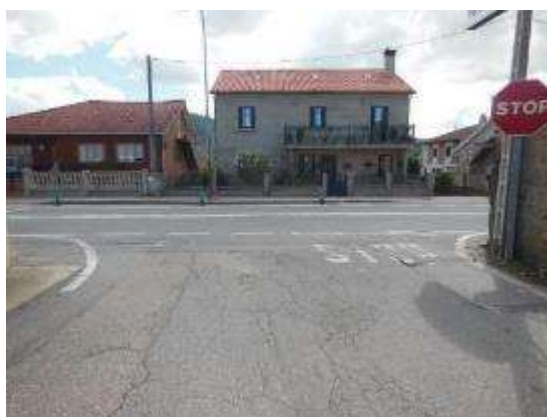
Foto 7. PK 8+530, incorporación margen derecho. Señal de STOP, señalización horizontal en mal estado.
