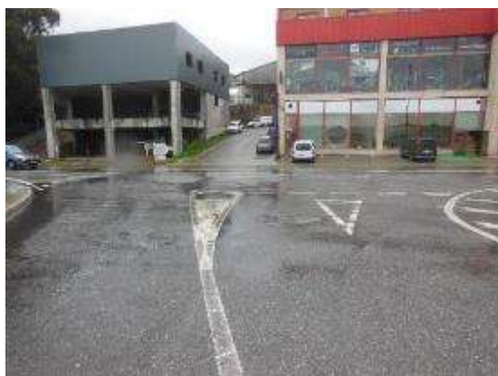
Foto 1. PK 2+200, incorporación sin señalización vertical y señalización horizontal desgastada.
