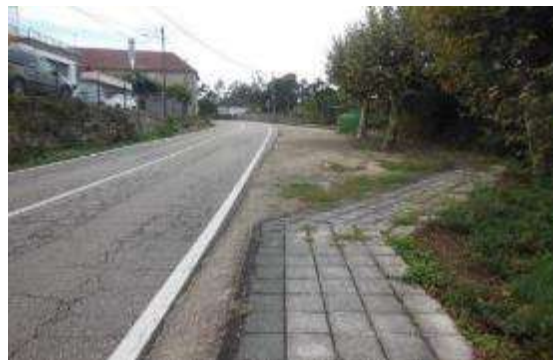
Foto 12. PK 0+900, sentido creciente, parada de autobús margen derecho. Diferencia de cota por discontinuidad en el pavimento. No existe señalización, mal estado de conservación parada de autobús.
