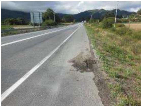
Foto 23. PK 1+440, sentido creciente. Blandón en el arcén con restos de tierra.
