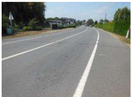
Foto 20. PK 23+540, sentido creciente. Vista general, blandones en margen derecho.
