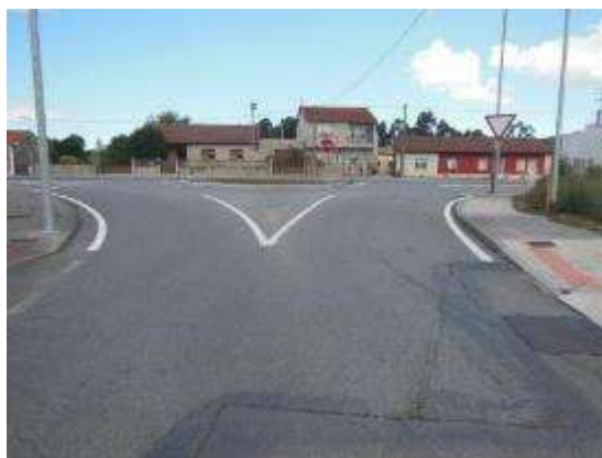
Foto 5. PK 8+460, vista general de la intersección, cambio de rasante. Señalización horizontal de ceda inapreciable.
