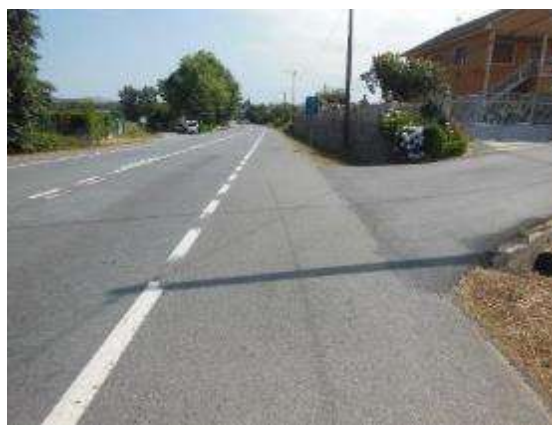
Foto 26. PK 24+020, sentido decreciente. Vista general, incorporación margen izquierdo sin señal STOP.
